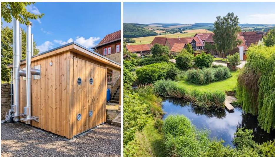
Regenerative und naturnahe Infrastruktur in unmittelbarer Nachbarschaft: Die Heizzentrale auf Hof 5 versorgt Hof 7 über das bestehende Nahwärmenetz; die Pflanzenkläranlage übernimmt derzeit die biologische Abwasserreinigung.
